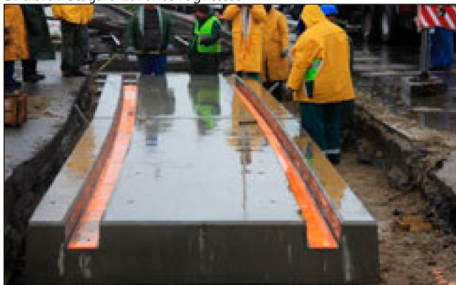
5. ábra: Útátjáró Edilonos rögzítéssel
