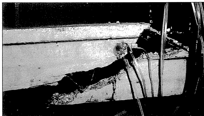
5. ábra: Feszített vasbeton tartó nyírási törése (Tassi, 1978)
